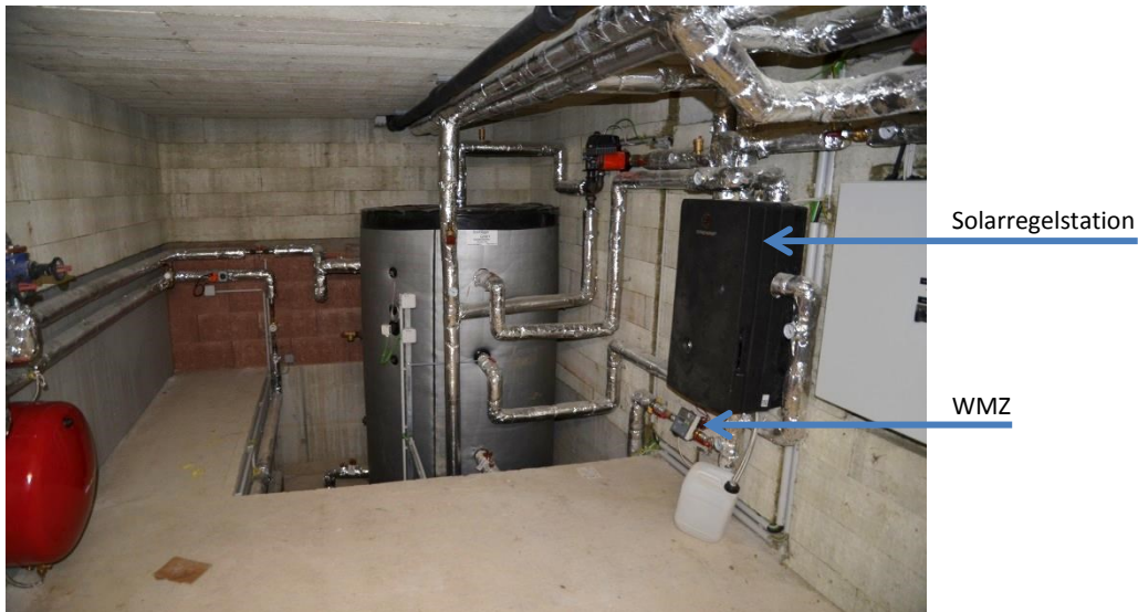
Abbildung 6: Solar-Pufferspeicher in Bauteil B 1.2
